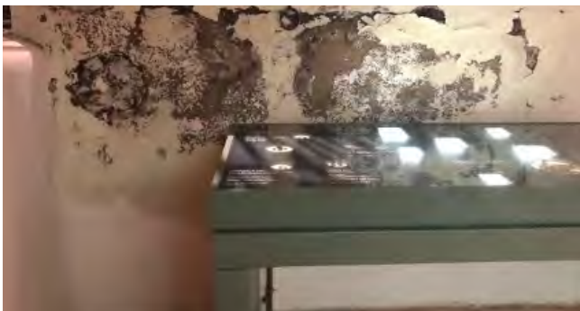
Tracce di umidità all'interno del quarto box seconda sala: Museo delle Navi Antiche di Pisa
